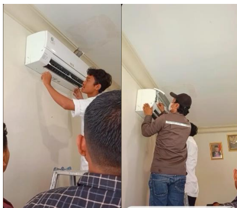
Gambar 5. Pengecekan Kebocoran di Indoor Area
