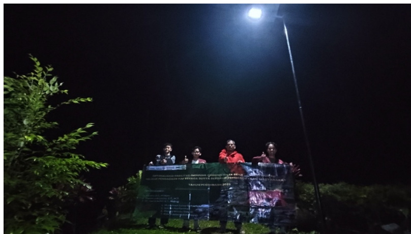
Gambar 4. Hasil Instalasi PJU Tenaga Surya
